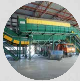
DREHSIEBANLAGEN UND SAMMLUNG UNTER DER SIEBANLAGE
